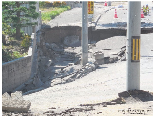
▼地盤の陥没状況
